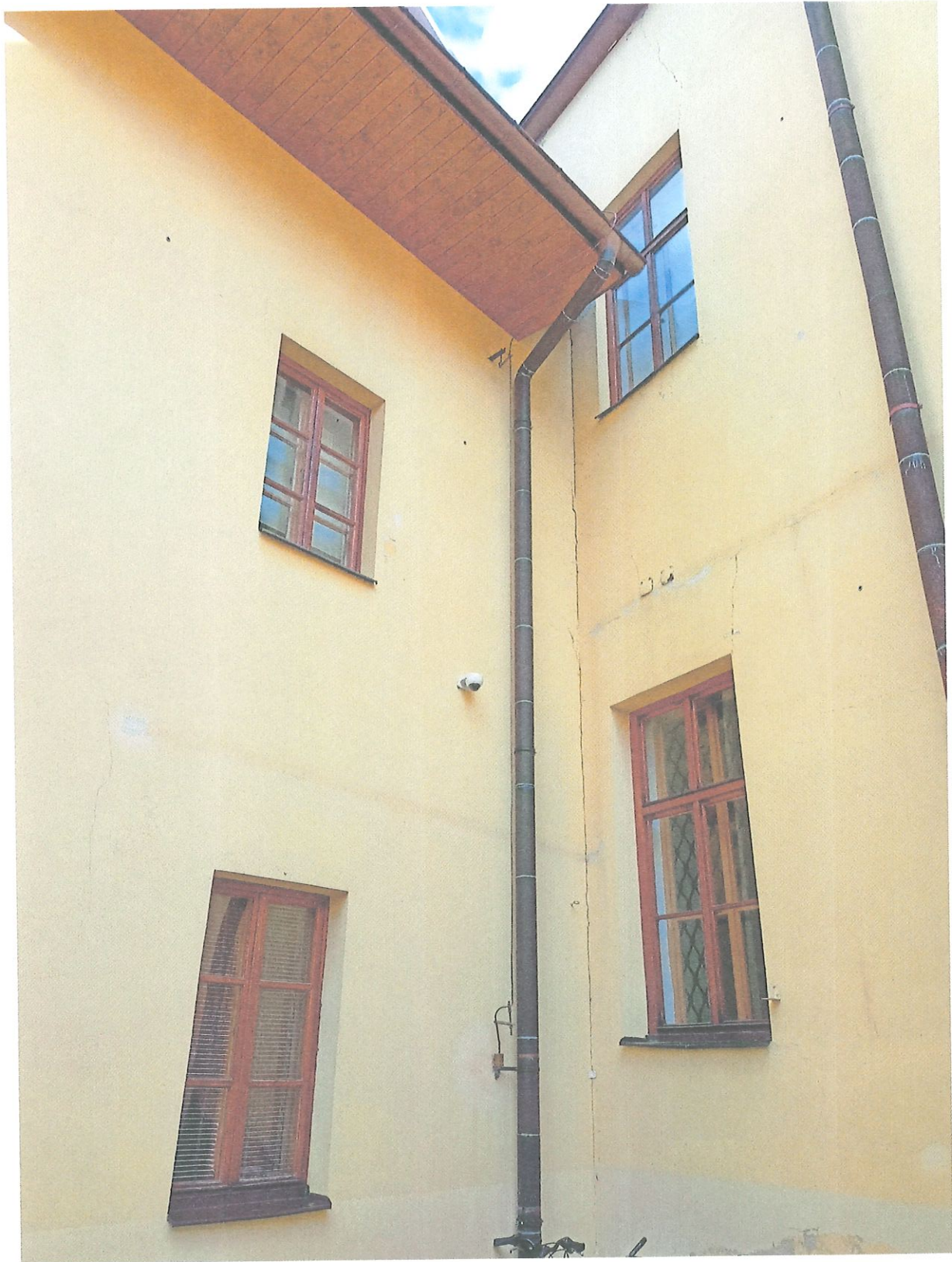
Fot. 3 Muzeum Podkarpackie w Krośnie, ul. Józefa Piłsudskiego 16, 38-400 Krosno, elewacja wewnętrzna – dziedziniec, widoczne największe okna drewniane, fot. K. Witalis 2021 r.
